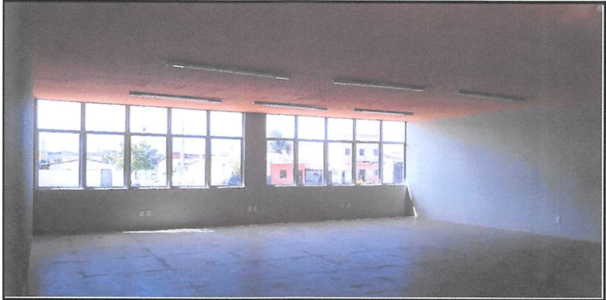
FOTO 15 VISTA DA SALA PARA LEITOS 01 DO PRÉDIO DESTINADO A IMPLANTAÇÃO DE UMA UNID. DE CAMPANHA DE ENFRENTAMENTO DO COVID-19
